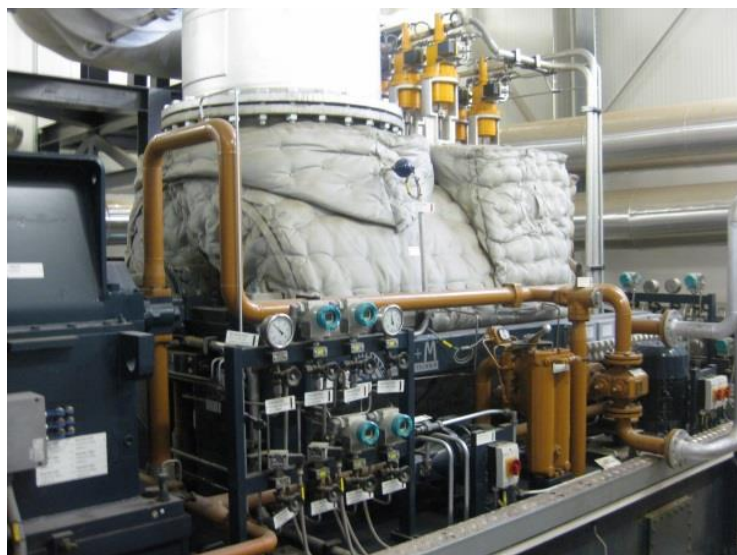
Slika 3.22. Parna turbina u elektrani
