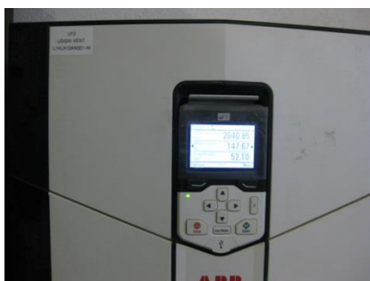
Slika 3.51. Regulator za usisni ventilator
