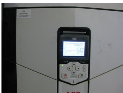
Slika 3.51. Regulator za usisni ventilator
