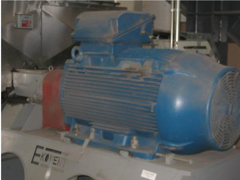
Slika 3.44. Motor usisnog ventilatora
