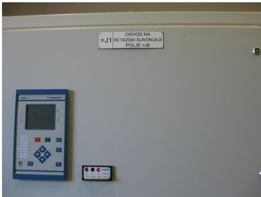
Slika 3.59. Kutija transformatora J1 u elektroenergetskoj prostoriji
