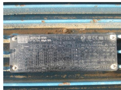
Slika 3.65. Pločica motora odsisnog ventilatora
