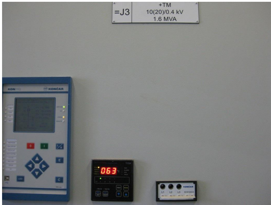
Slika 3.60. Kutija ransformatora J3 u elektroenergetskoj prostoriji
