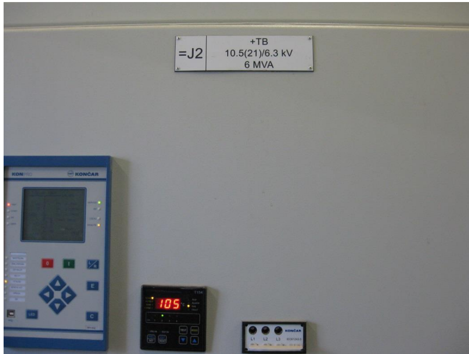
Slika 3.61. Kutija transformatora J2 u elektroenergetskoj prostoriji
