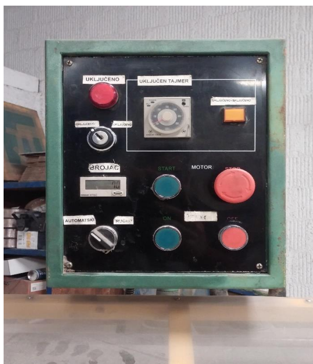
Slika 4.31. Kontrolna kutija zaklopne štanice
