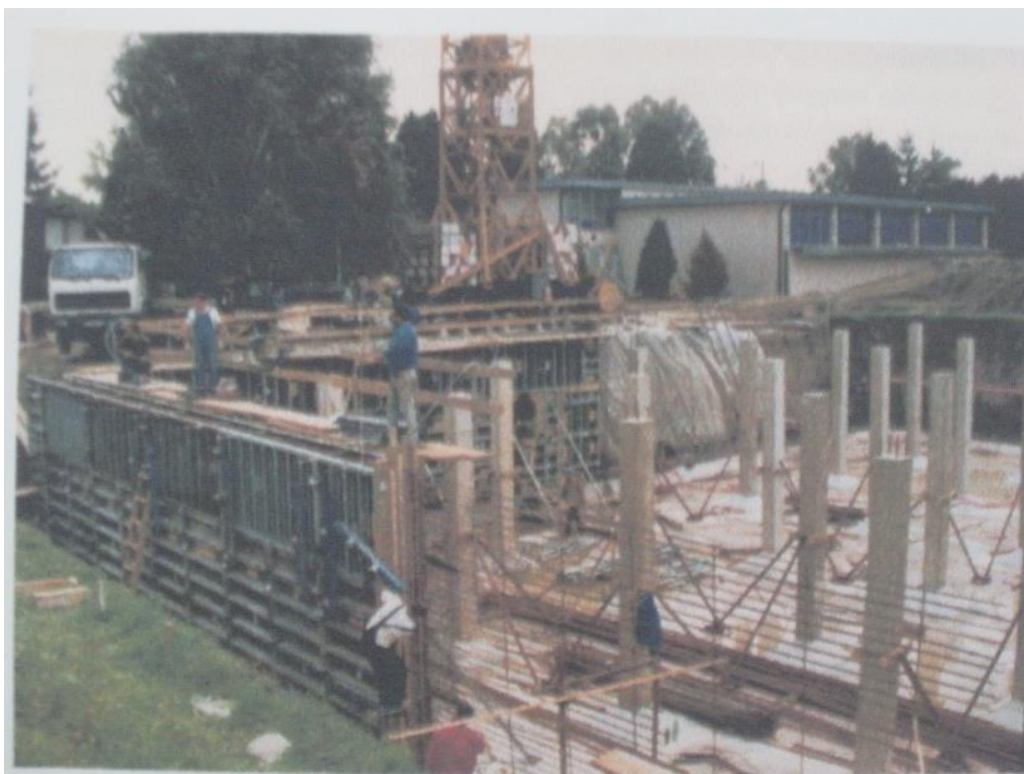
Slika 3.1. Vodosprema pitke vode 2500 m 3
