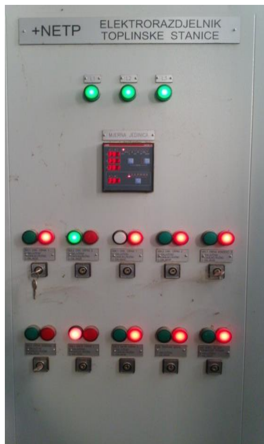
Slika 5.21. Elektrorazdjelnik toplinske stanice
