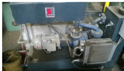
Slika 4.13. asinkroni motor vakuuma pumpe
