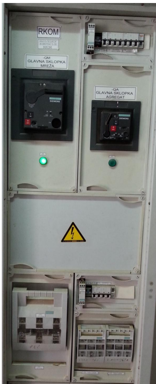
Slika 5.10. Glavna sklopka mreže i pomoćni agregat
