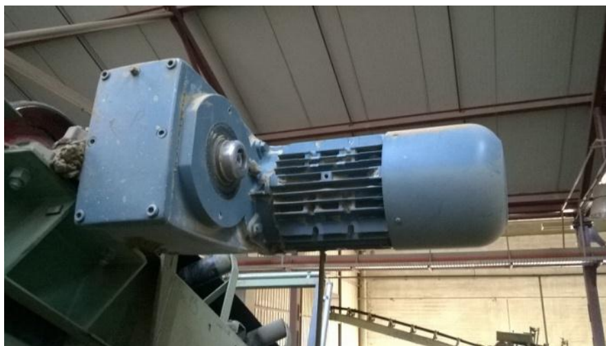
Slika 4.7. Transportna traka i asinkroni motor
