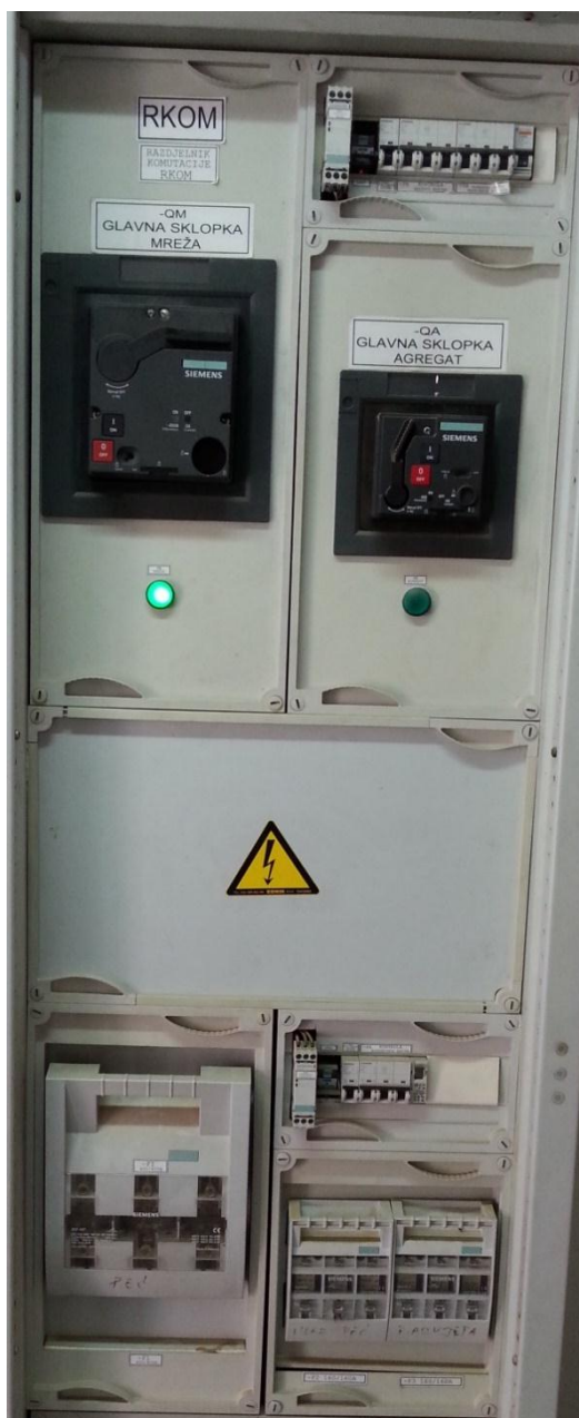
Slika 5.10. Glavna sklopka mreže i pomoćni agregat
