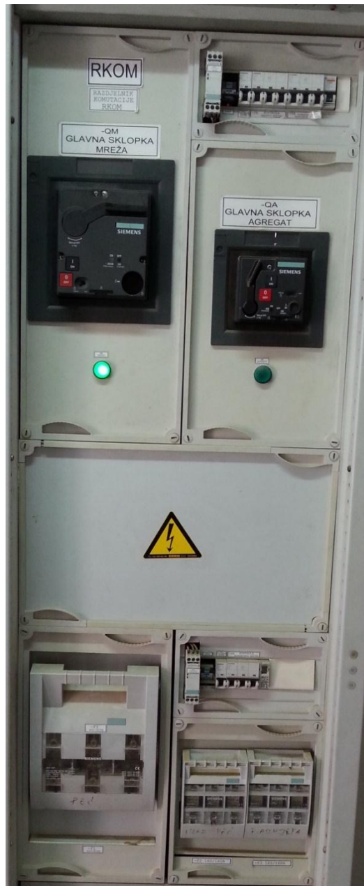
Slika 5.10. Glavna sklopka mreže i pomoćni agregat
