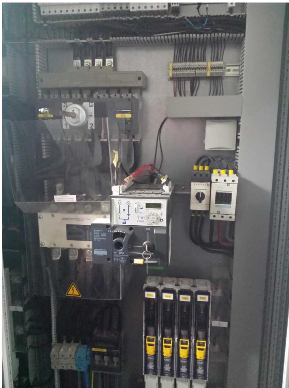
Slika 5.20. Unutrašnjost transformatorske stanice [fotografirano 1. prosinca 2014.]
