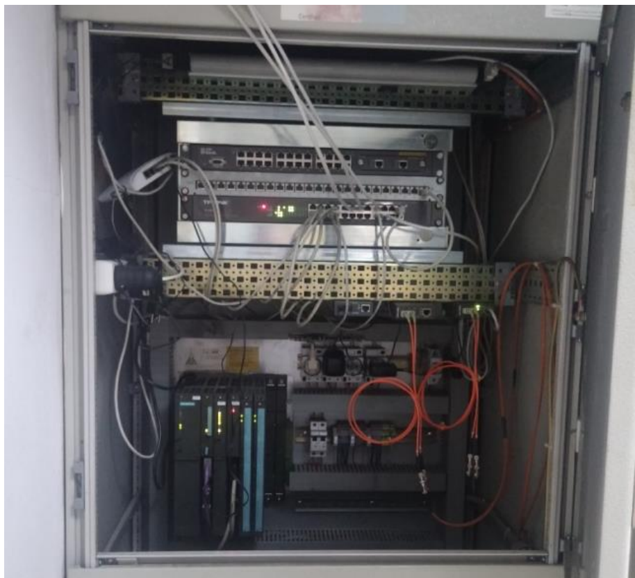
Slika 2.8. Centralna upravljačka jedinica
