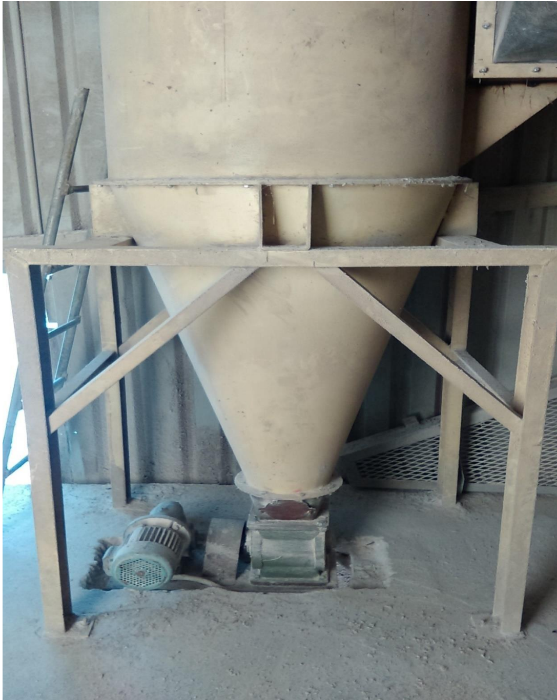
Slika 2.10. Ventilator (unutar skladišnog prostora) za odvajanje prašine od zrna žitarice
