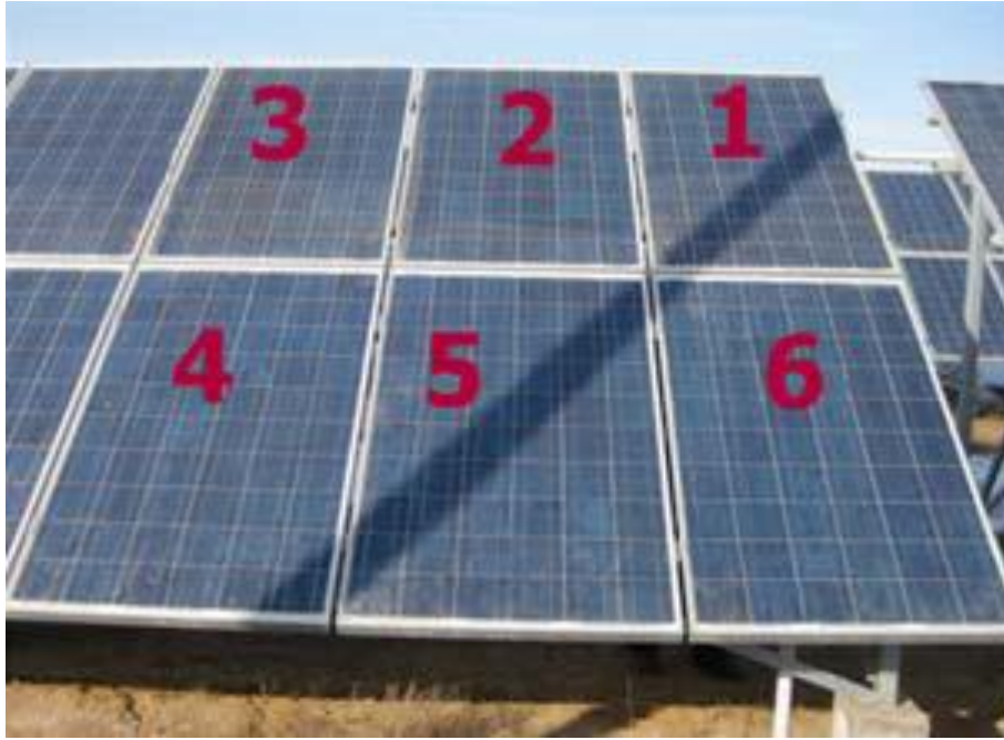
Slika 2.1. Zasjenjenja na numeriranim fotonaponskim modulima uzrokovana dijelovima distribucijskog sustava, kao što su vodovi ili nosivi stupovi vodova, u blizini fotonaponskih sustava.
