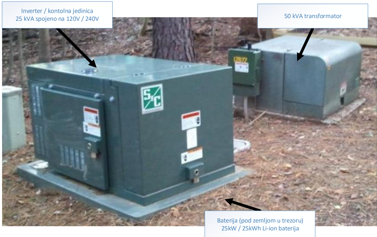
Slika 4.4 Sustav pohrane energije sa transformatorom, Charlotte, Sjeverna Karolina [9]
