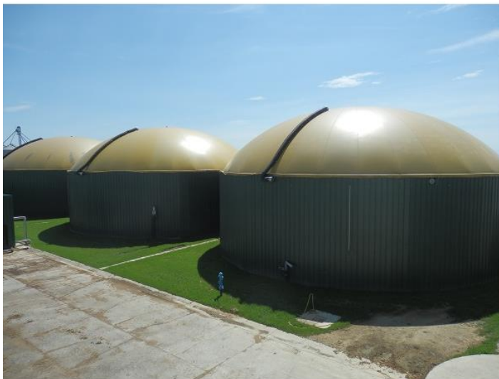
Slika 2.11. Digestor s balonom na vrhu u bioplinskom postrojenju [3]
