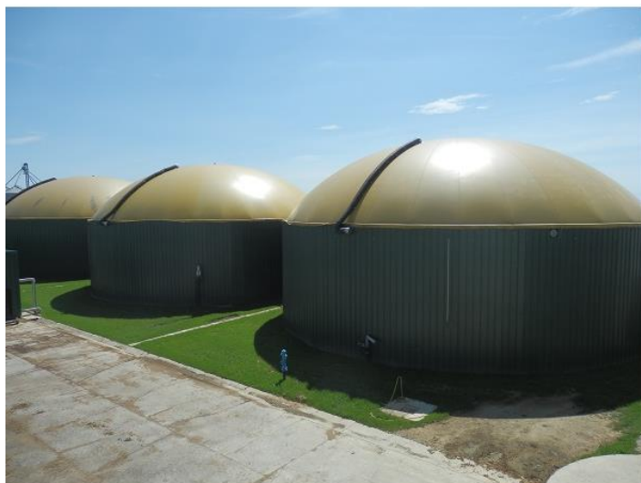
Slika 2.11. Digestor s balonom na vrhu u bioplinskom postrojenju [3]
