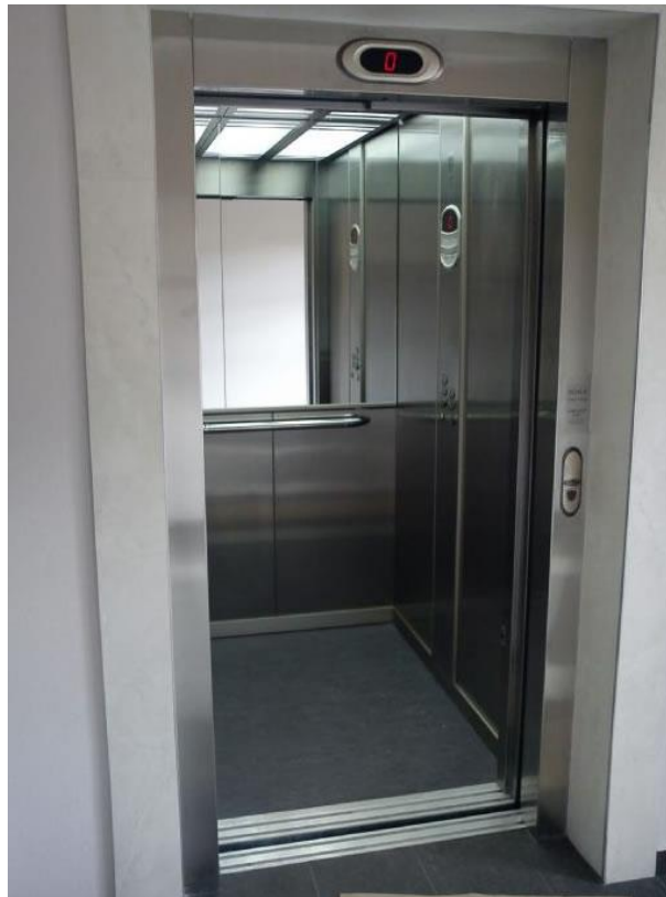
Slika 3.4. Primjer unutrašnjosti etažnog dizala [4].
