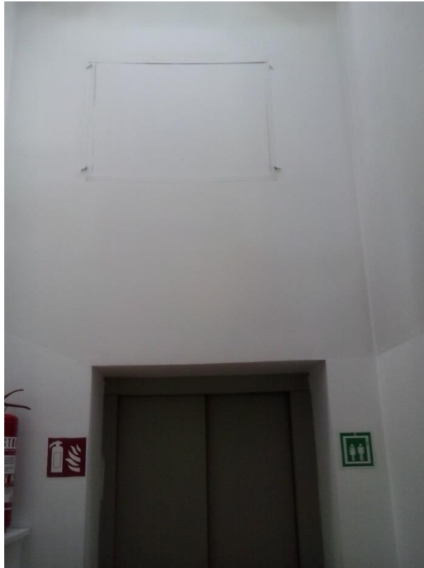
Slika 4.4. Prilaz motoru dizala iznad ulaznih vrata.
