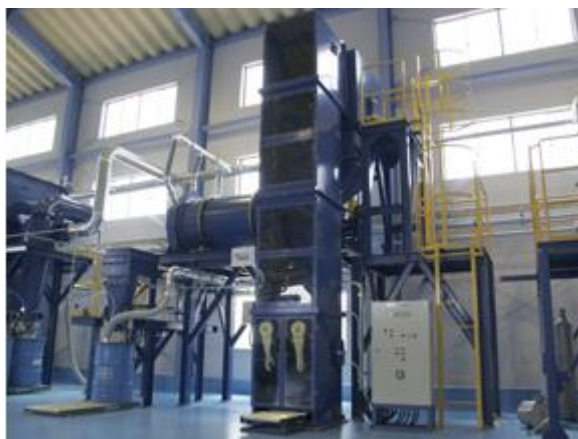
Slika 4.7. Jedinica postrojenja za odvajanje fosfornog praha sa živom od krutog materijala
