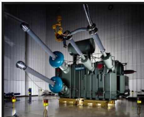
Slika 2.20. HVDC Pretvarački transformator [9]
