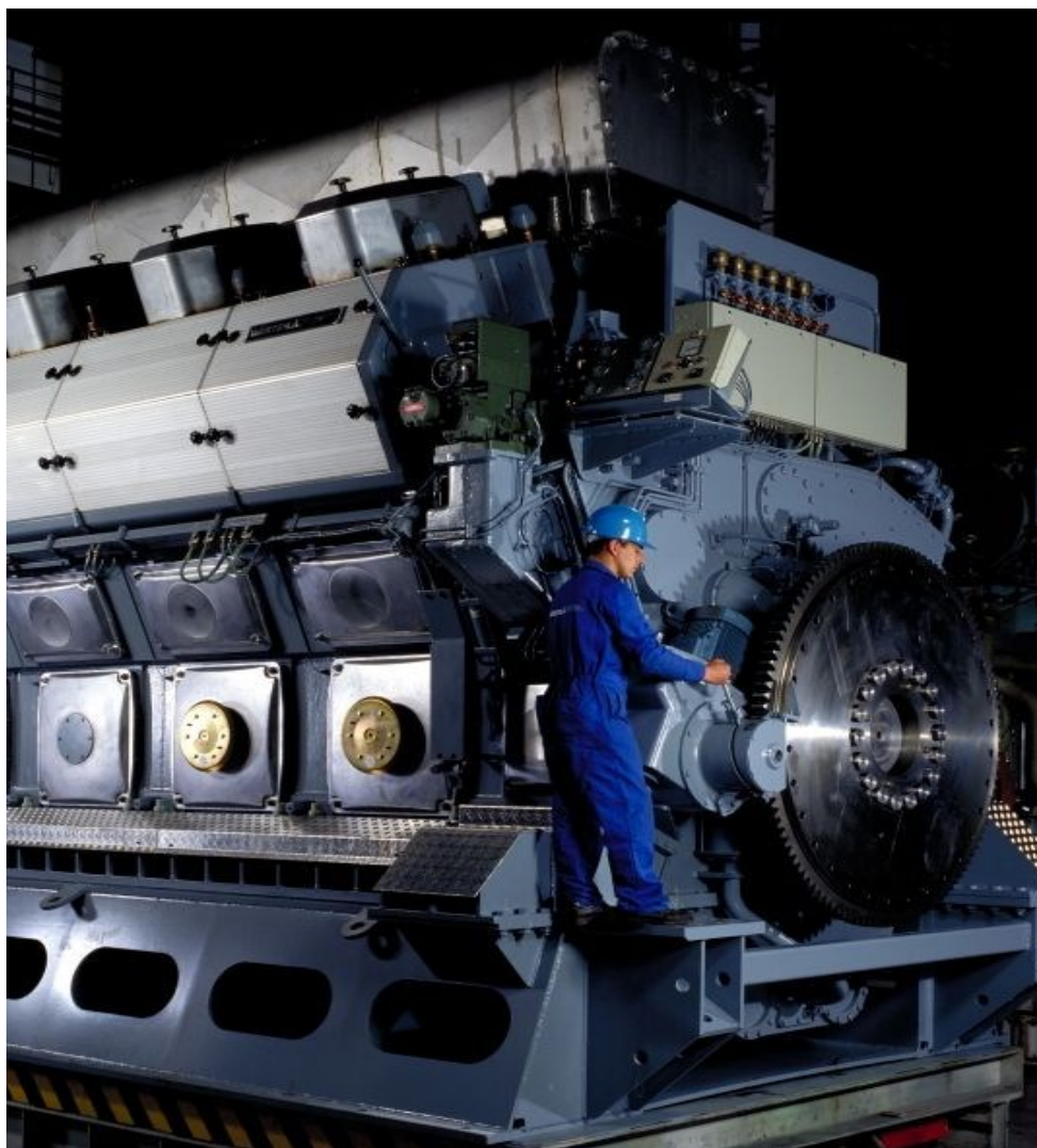
Slika 5.3.4. Dizel generator Wartsila 16V46C strana vratila
