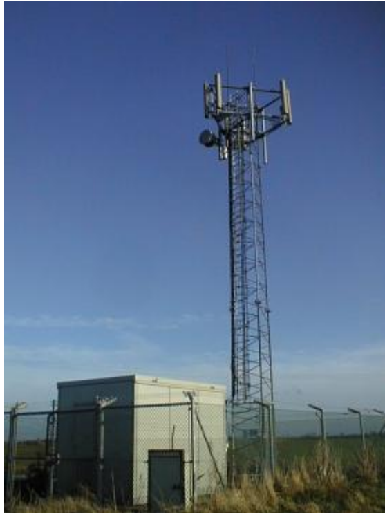
Sl. 3.3. Bazna postaja montirana na samostojećem stupu [11].
