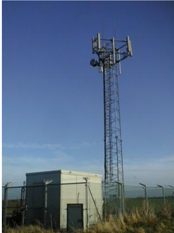
Sl. 3.3. Bazna postaja montirana na samostojećem stupu [11].
