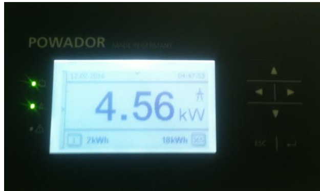
Slika 2.3. Prikaz upravljačke ploče izmjenjivača
