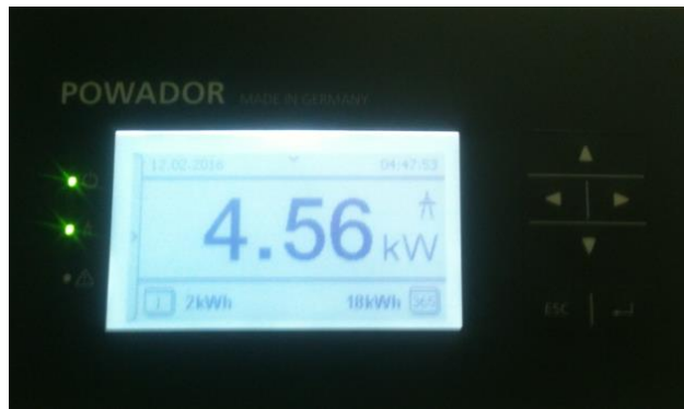
Slika 2.3. Prikaz upravljačke ploče izmjenjivača
