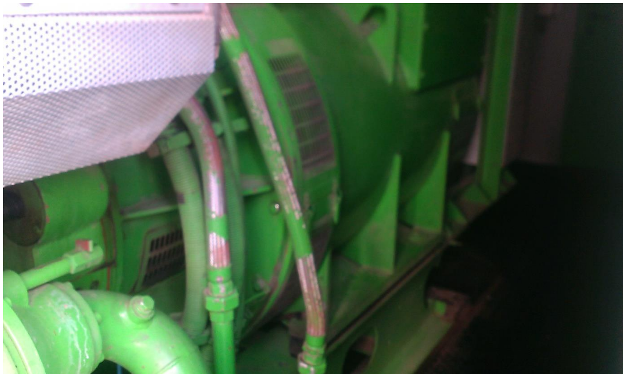
Slika 5.20. Prikaz generatora bioplinskog postrojenja Landia d.o.o.
