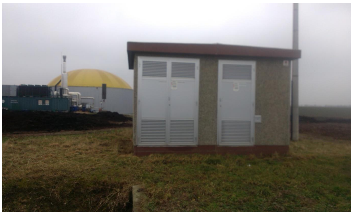
Slika 5.23. Transformatorska stanica HEP-a
