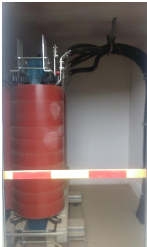
Slika 5.22. Unutrašnjost transformatorske stanice
