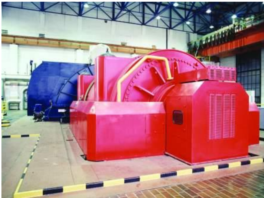
Slika 2.1. Turbogenerator termoelektrane Plomin u Hrvatskoj, 1x247 MVA [3]
