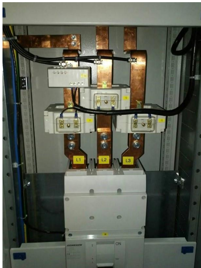
Slika 3.2. Mjerni transformatori (strujni) u električnom ormaru - Nova Gradiška, 2017.
