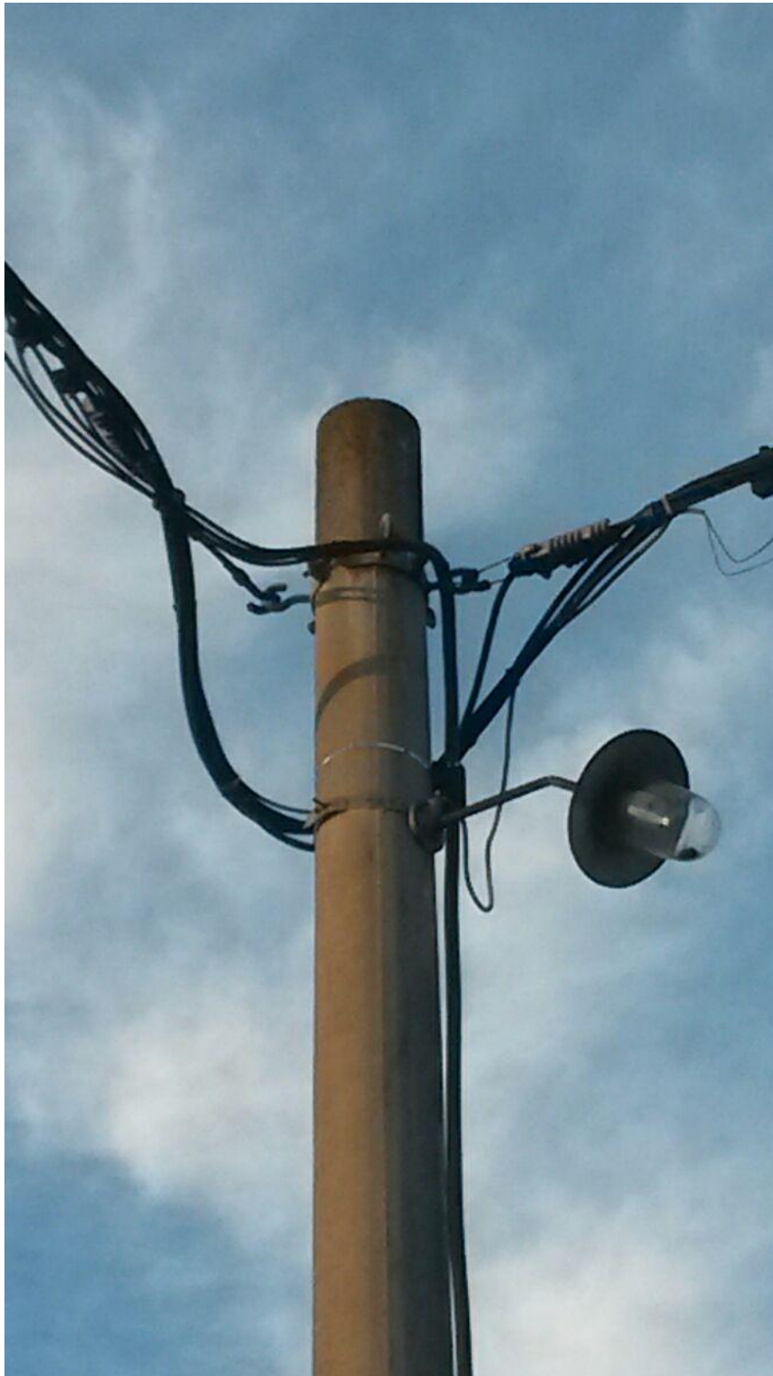
Slika 3.6. Kutni betonski stup s javnom rasvjetom
