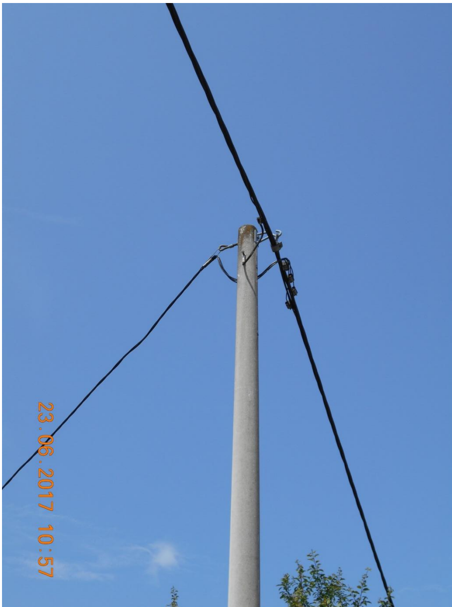
Slika 3.2. Linijski nosivi betonski stup s kućnim priključkom
