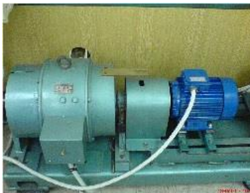
Slika 4.1. Asinkroni motor(desno) i istosmjerni generator
