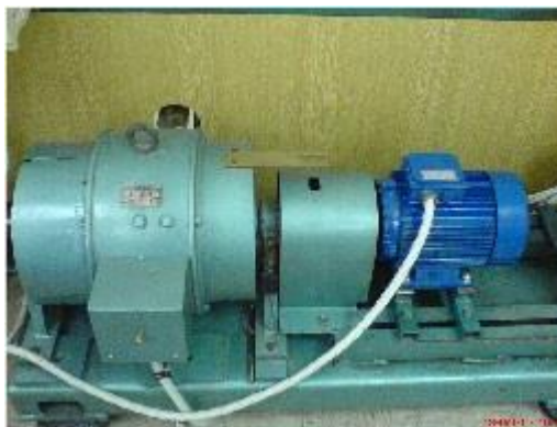
Slika 4.1. Asinkroni motor(desno) i istosmjerni generator
