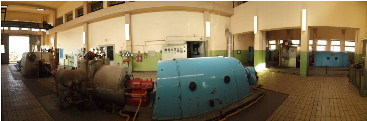
Slika 7.1. Energana u Tvornici šećera Osijek
