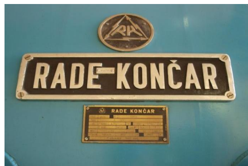
Slika 7.2. Generator Rade Končar 10 MW
