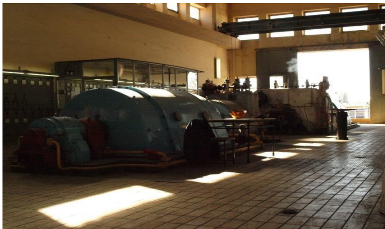
Slika 7.4. Generator Rade Končar 2,5 MW
