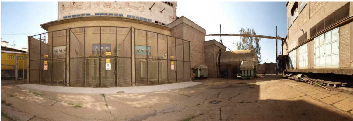
Slika 8.1. Transformatori 35/6,3 kV u Tvornici šećera Osijek
