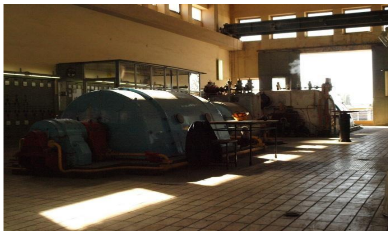
Slika 7.4. Generator Rade Končar 2,5 MW
