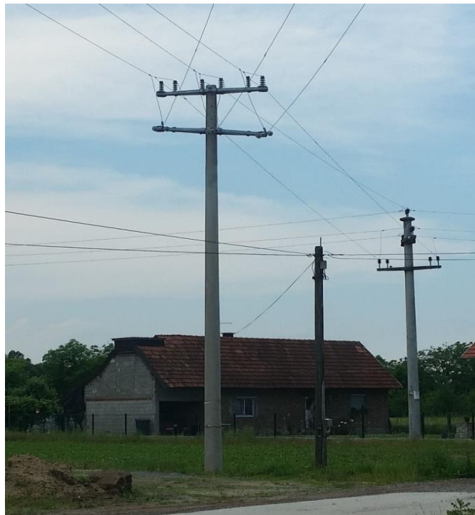
Sl. 3.10. Betonski odcjepni 10 kV stupovi s različitim oblicima glave stupa
