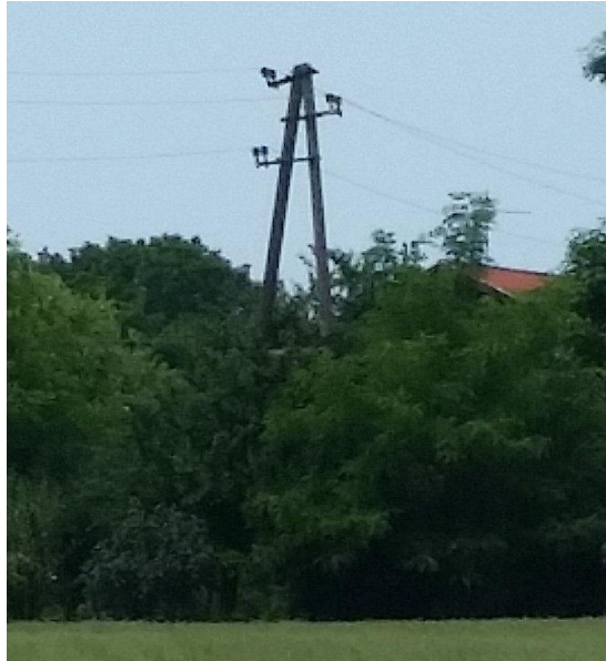
Sl. 3.6. Drveni 10 kV A-stup
