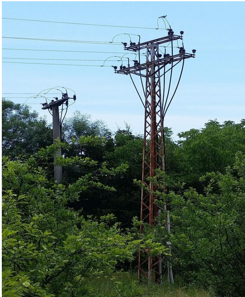
Sl. 3.11. Krajnji betonski i čelično rešetkasti 10 kV stupovi
