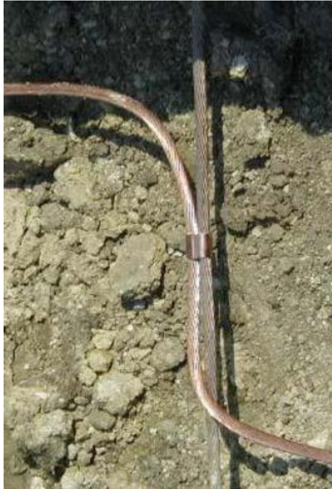
Slika 2.3: Primjer uzemljivača (bakreno uže) [3]
