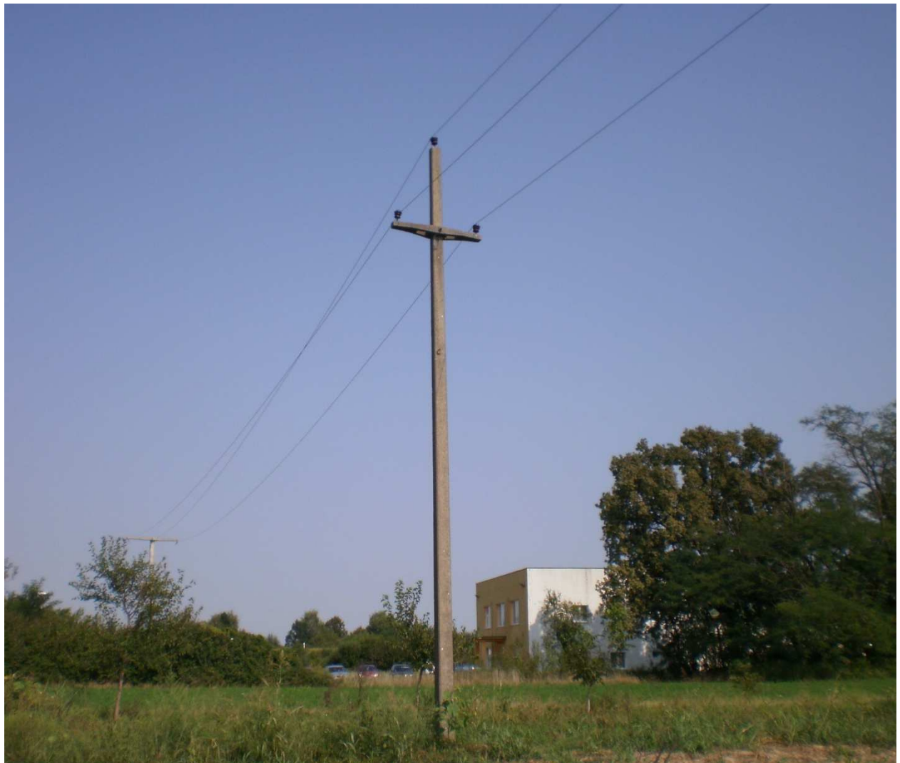
Sl. 2.16. Betonski stup 10 kV
