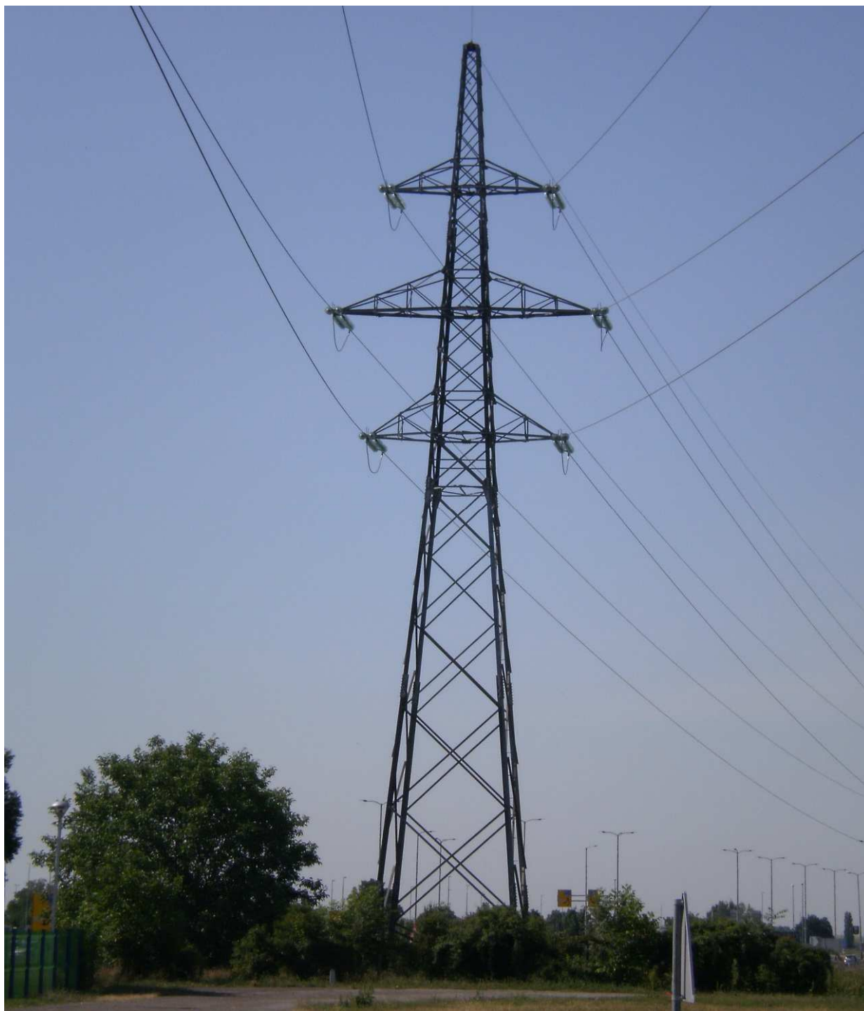
Sl. 2.14. Dvostruki čelično-rešetkasti stup 110 kV
