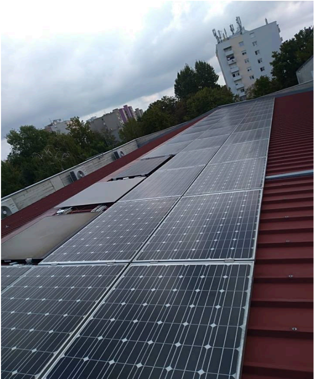
Slika 3.3. Fotonaponska elektrana FERIT-a
