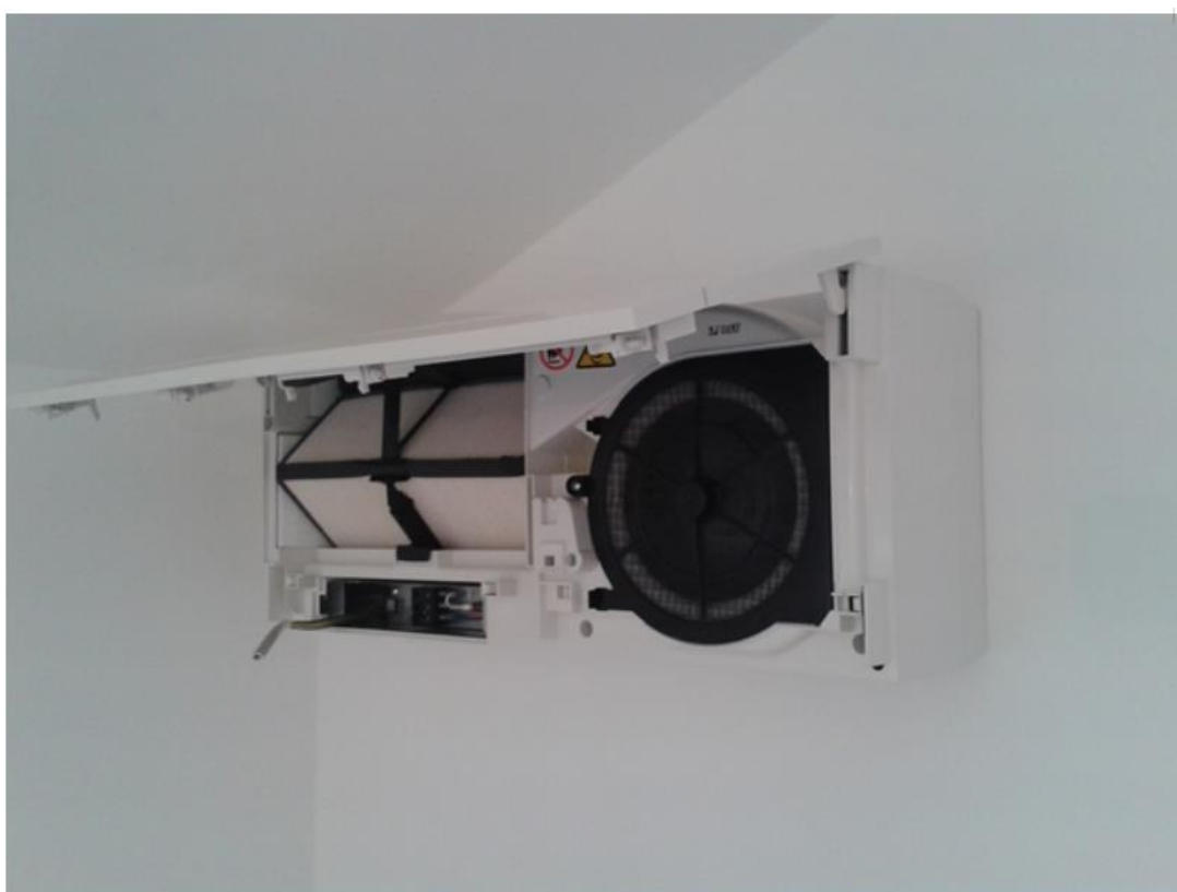
Slika 3.27 Otvorena montirana unutarnja rekuperacijska jedinica
