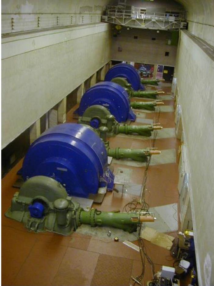
Slika 2.7. Agregati s po dvije turbine instalirane snage 15,75MW[1]
