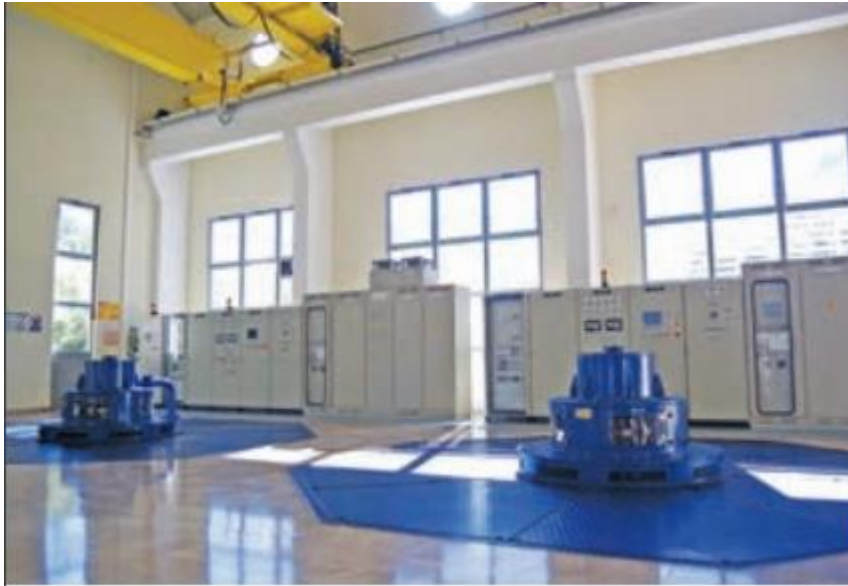
Slika 2.10. Trofazni sinkroni generatori KONČAR 18MWA[8]
