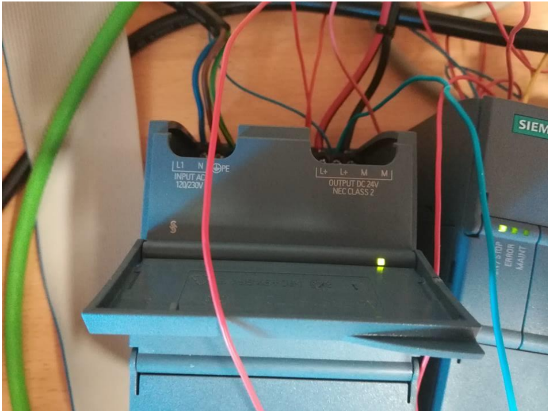
Slika 10 Napajanje PLC uređaja
