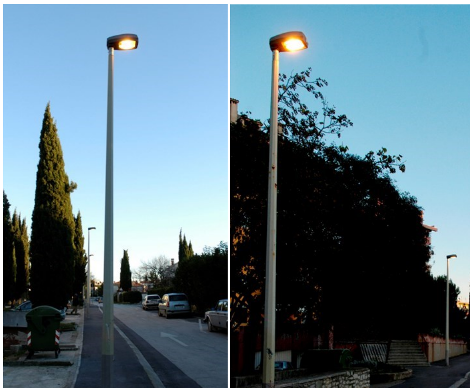
Slika 4.14. Rasvjetna tijela nakon rekonstrukcije u gradu Rovinju [8]
