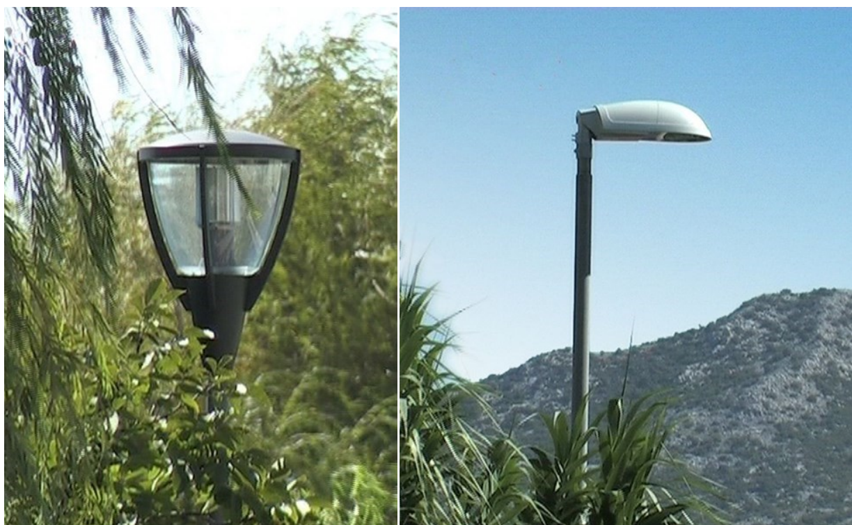
Slika 4.16. Nova modernizirana javna rasvjeta u Solinu [8]
