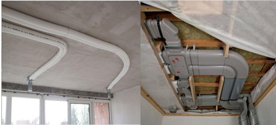
Slika 4.8. Položaj zračnih kanala u stambenoj zgradi i primjer odsisnih kanala za zrak. Kanali za zrak su bitan dio investicije i potrebno je strojarsko iskustvo u projektiranju kanala kako nebi došlo do čestih mehaničkih kvarova, [18].
