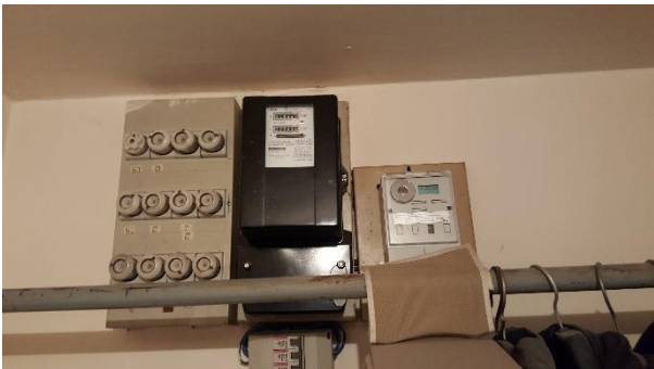
Slika 4.43. Karakteristični razdjelni ormar karakterističnog stambenog prostora.
