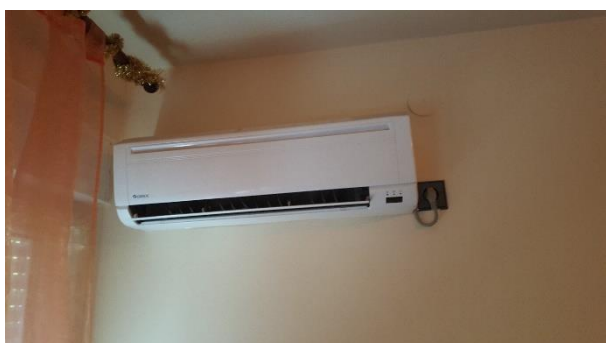
Slika 4.33. Jedan od split klima uređaja (unutarnja jedinica).
