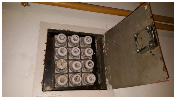
Slika 4.44. Karakteristični etažni razdjelni ormar.
