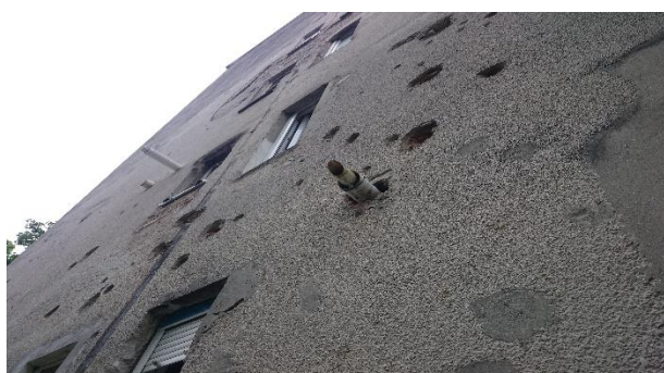
Slika 4.36. Jedan od fasadnih ispuha plinskiх kombi bojlera.
