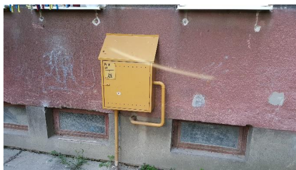
Slika 4.38. Glavni plinski priključni mjerni ormarić zgrade (MRS).
