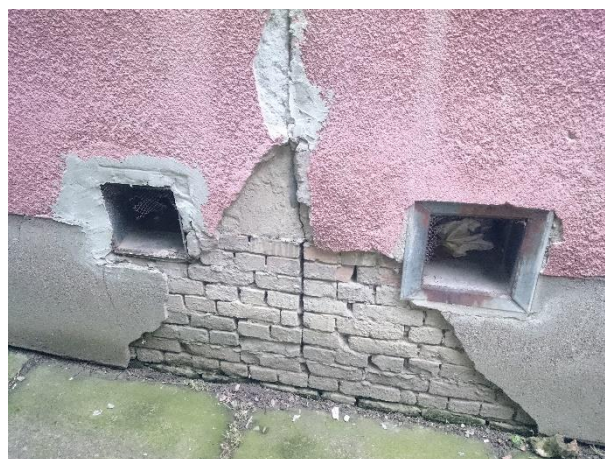
Slika 4.22. Oštećenja na cokol zidu podruma.
