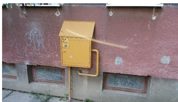
Slika 4.38. Glavni plinski priključni mjerni ormarić zgrade (MRS).
