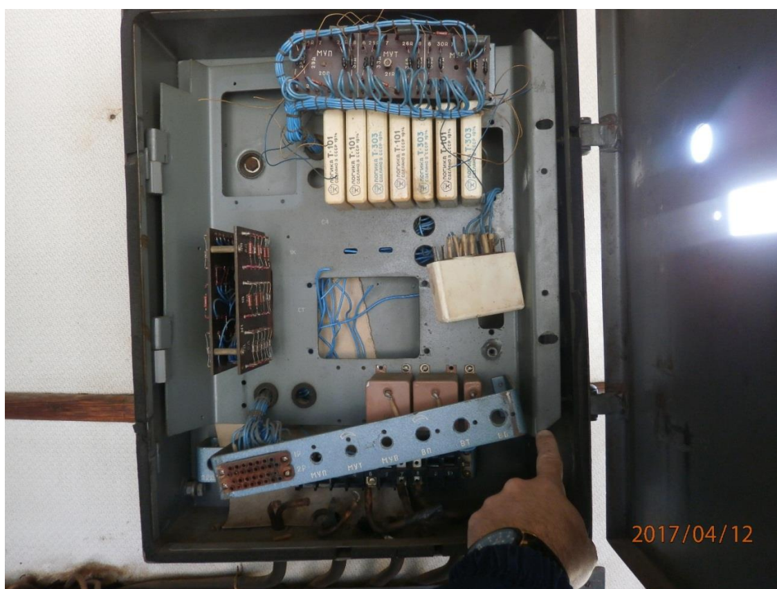
Slika 2.2. Izgled unutrašnjosti upravljačkog ormara u upravljačkoj kabini
