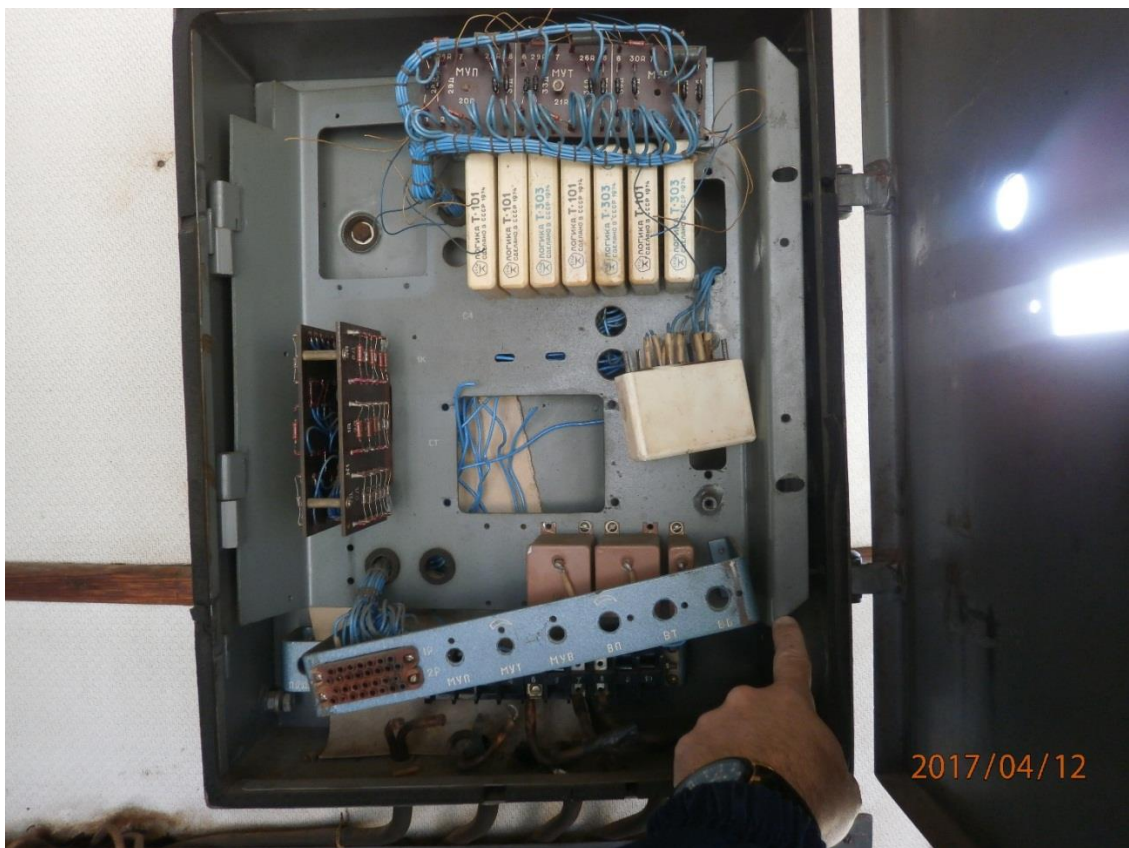
Slika 2.2. Izgled unutrašnjosti upravljačkog ormara u upravljačkoj kabini
