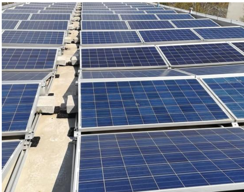
Slika 6.1. fotonaponska elektrana na kojoj je provedeno mjerenje
