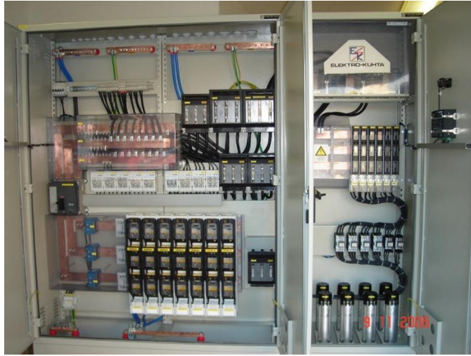
Sl. 5.1.1. Unutrašnjost razvodnog ormara
