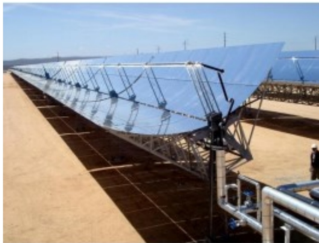
Slika 3.6. Postrojenje s paraboličnim žljebastim kolektorima [7]
