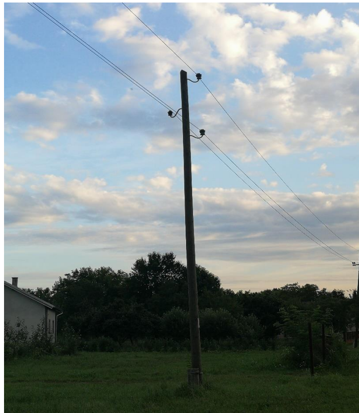
Slika 4.12. 10(20) kV linijski drveni stup
