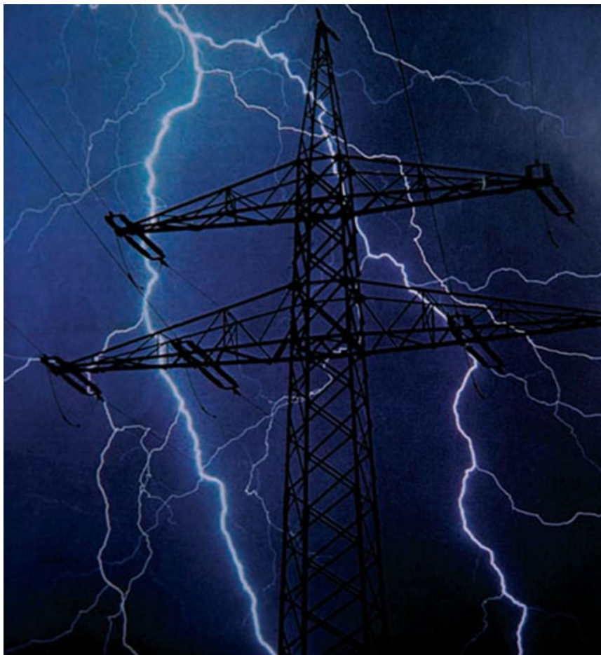
Slika 3.6. Udar groma u blizini dalekovoda [3]
