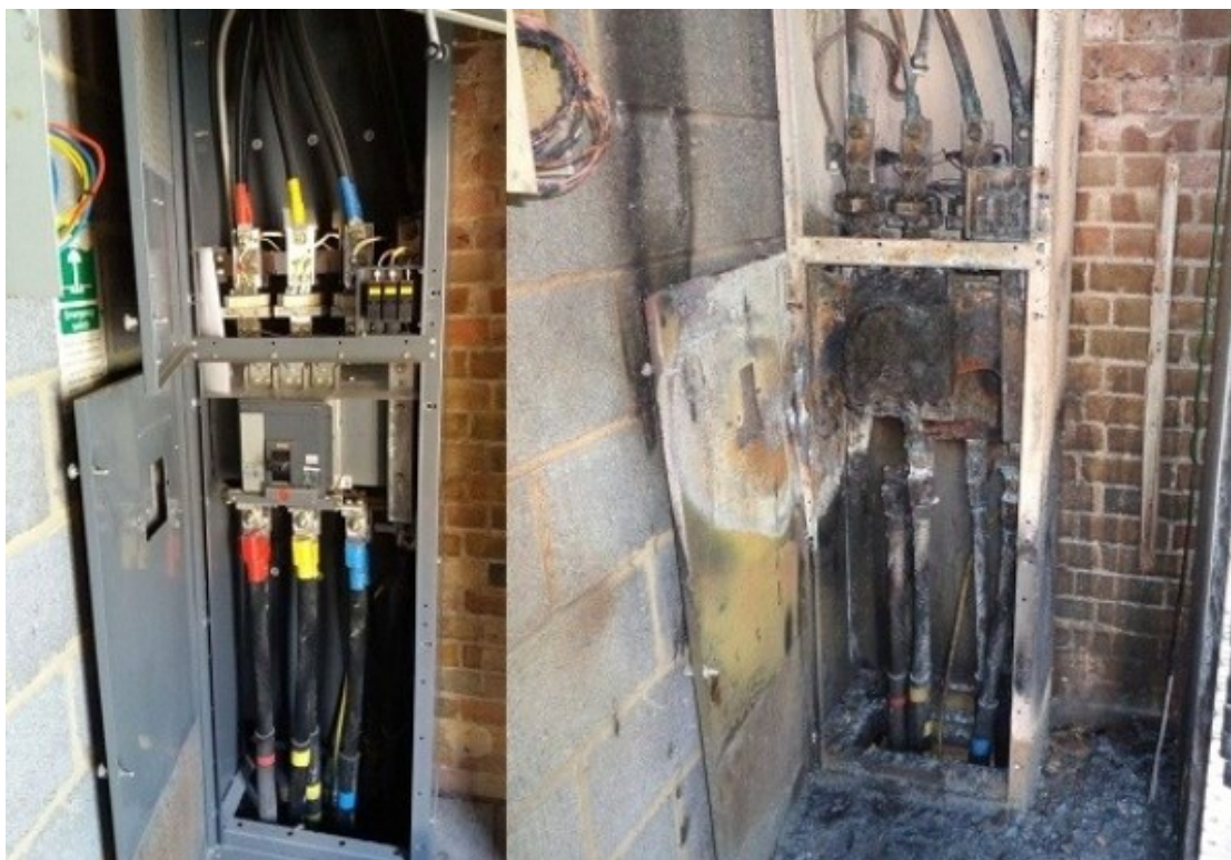
Slika 2.1. Instalacije nakon električnog luka. [1]
