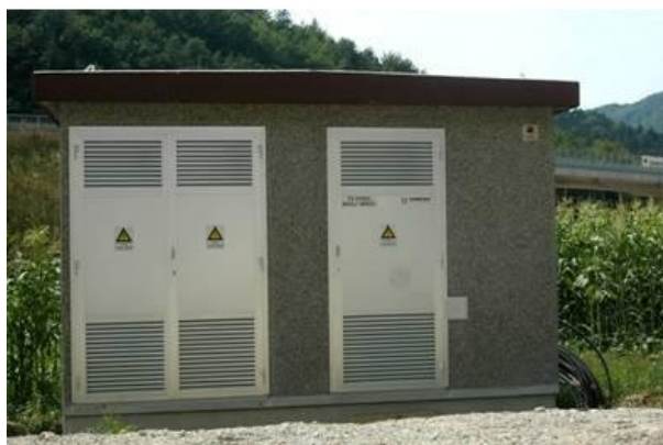
Slika 56. Tipika distribucijska trafostanica 1x630(1000) kVA Zagorje tehnobeton d.d. Varaždin
