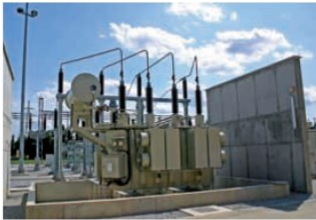
Slika 54. Transformator od 20 MVA u trafostanici 110/10(20) kV Osijek 4
