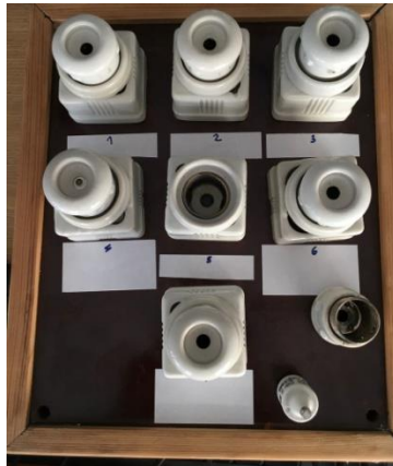
Slika 4.6. Ploča sa osiguračima na kojoj su odrađena mjerenja
