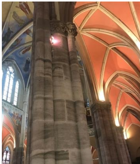
Slika 6.4 Postojeća rasvjeta (indirektna rasvjetna tijela)
