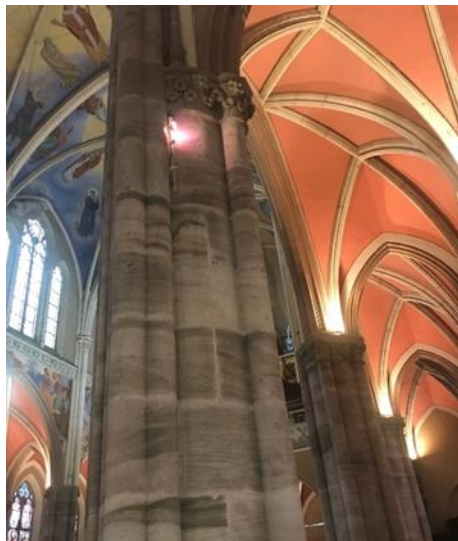
Slika 6.4 Postojeća rasvjeta (indirektna rasvjetna tijela)
