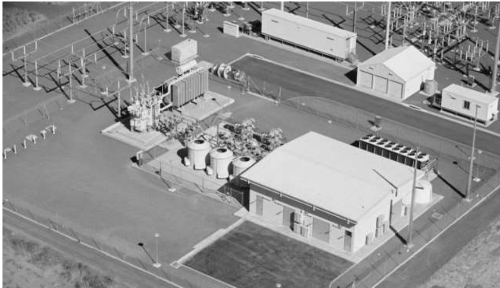
Slika 19.2 SVC postojenje – zračni snimak
