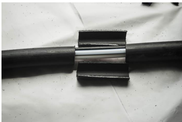
Slika 5.14: Odrezani dio PE50 cijevi s mikrocijevima
