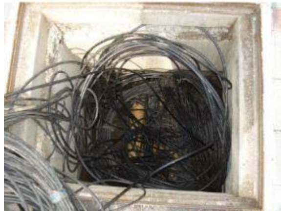
Slika 3.2: Stvarno stanje kabela u kabelskoj kanalizaciji, [13]
