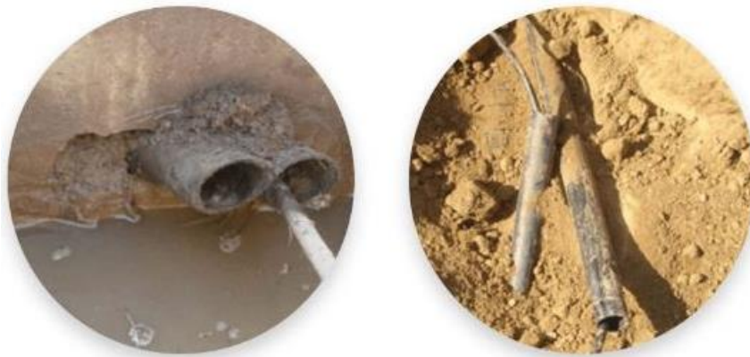
Slika 3.3: Stvarno stanje kabela u kabelskoj kanalizaciji - posljedica neodržavanja, [13]
