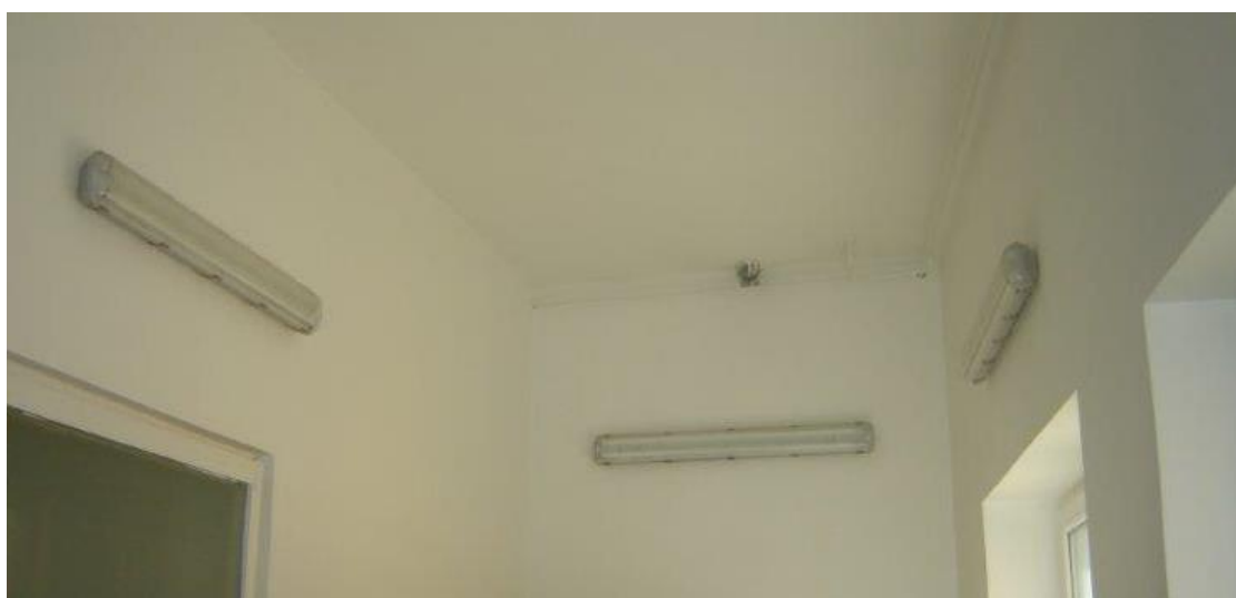
Slika 3.3. Trenutno stanje – rasvjeta u sanitarnim prostorima [19]
