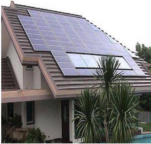
Slika 3.3. Solarni paneli na kući
