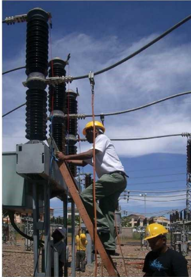
Sl.4.1. Prekidač uzemljen prilikom probe ispitivanja
