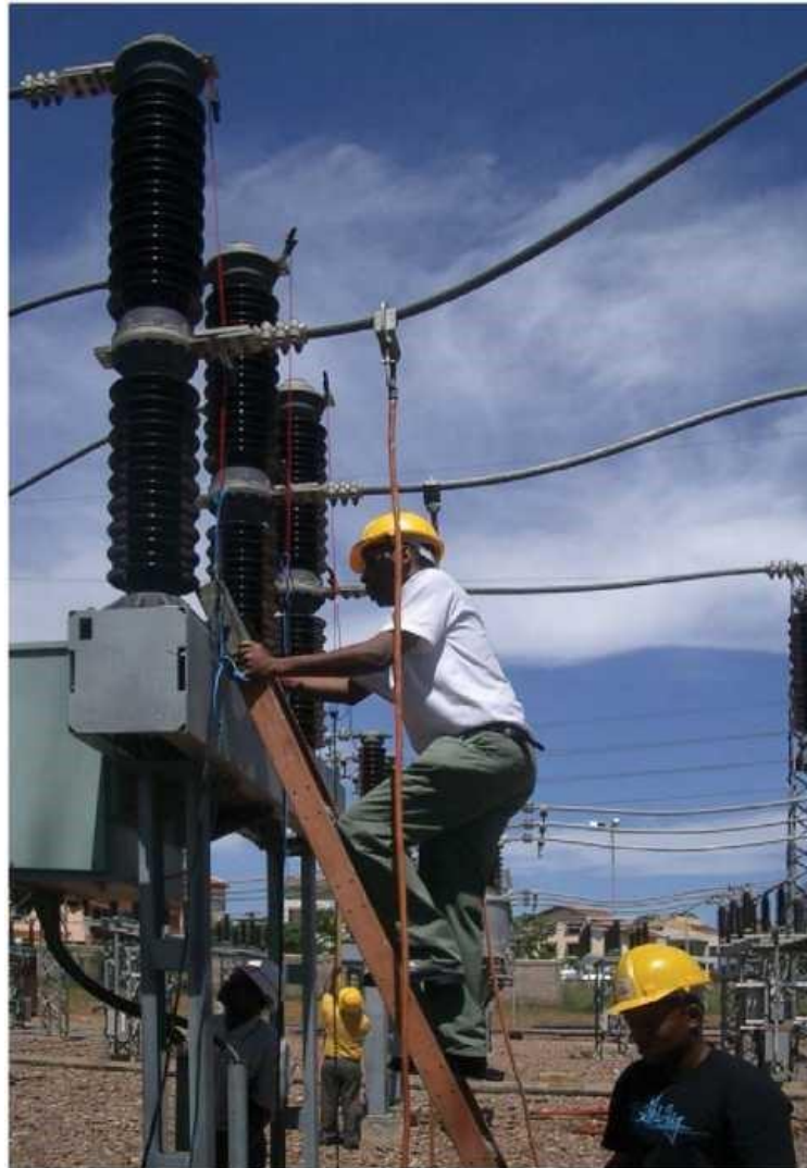
Sl.4.1. Prekidač uzemljen prilikom probe ispitivanja
