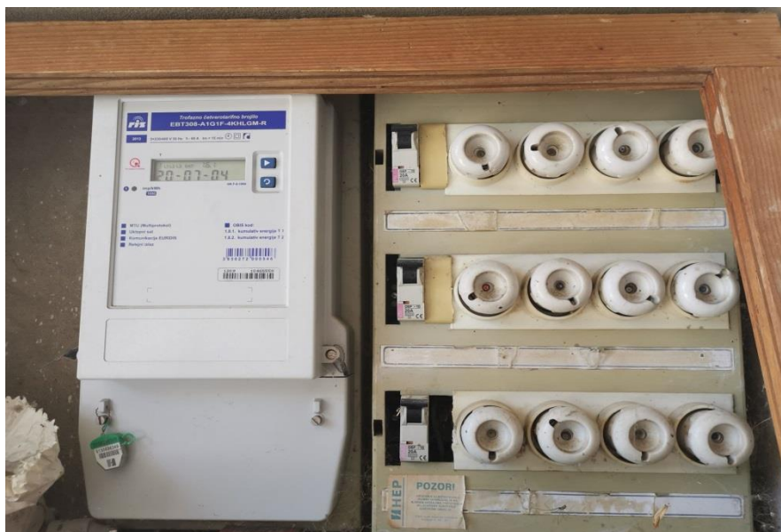
Slika 3.7: Podžbukna razvodna kutija s rastalnim osiguračima
