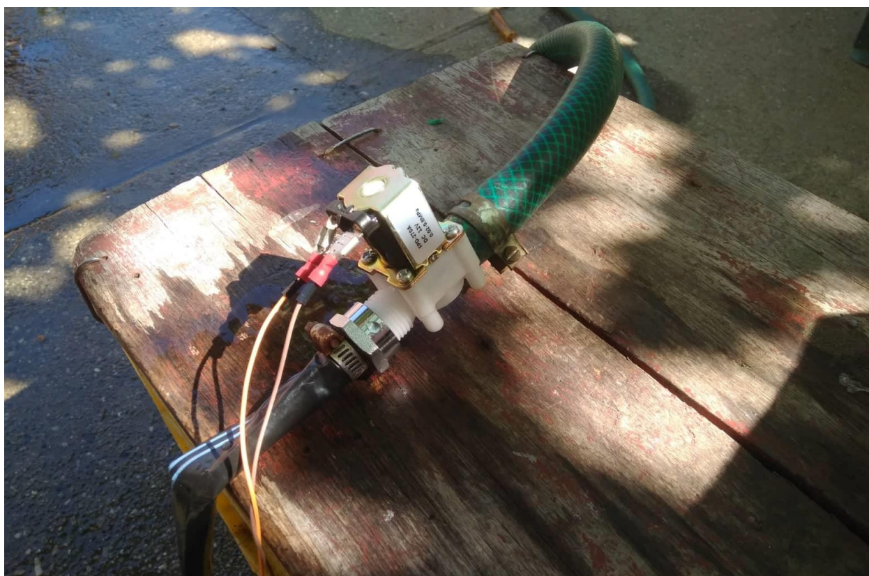
Slika 4.8: Magnetni ventil spojen na vrtno crijevo i crijevo za kap po kap navodnjavanje.
