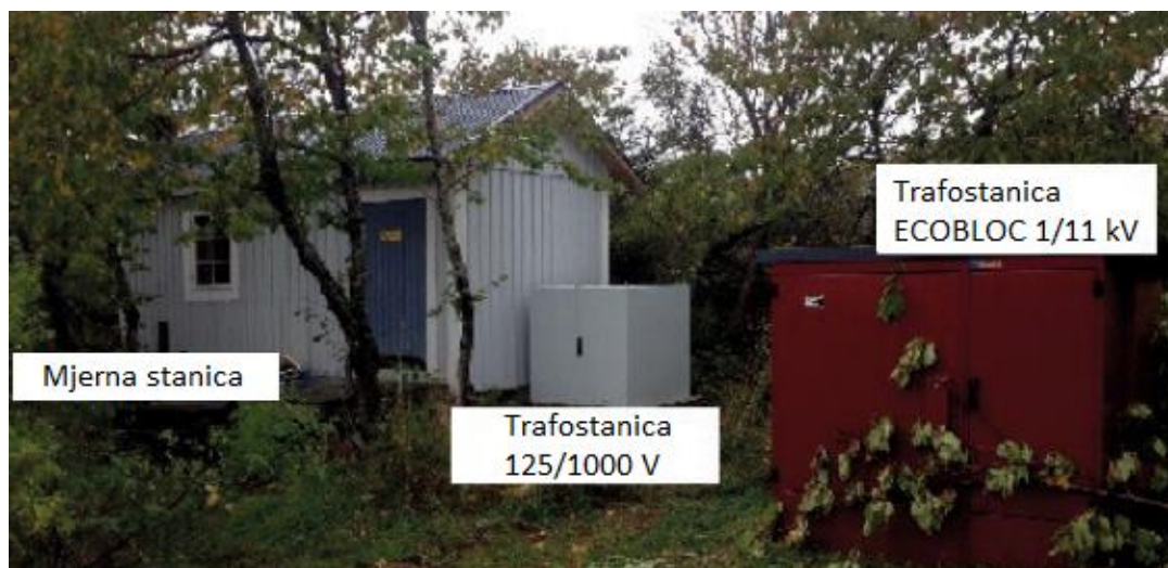
Slika 3.4. Mjerna stanica spojena na glavni mrežni transformator ECOBLOC (1/11 kV) kroz Hexaformer (0,125/1 kV) u Härmanöu u Lysekilu [1].
